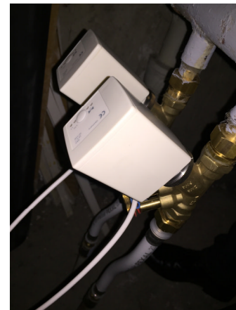
Moteur SK monté en gaine palière
